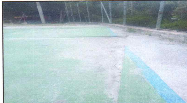
Foto 4: Sustrucción de concreto en mal estado.
